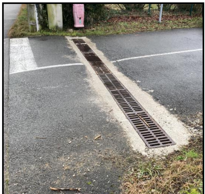
Restauration du caniveau d'eau pluviale à l'entrée de la Rue du Belvoire.
